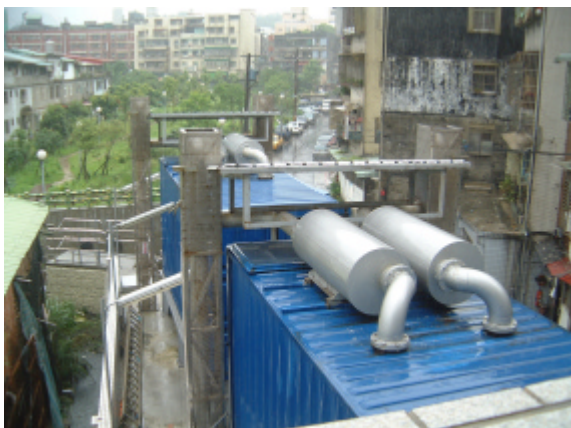
貨櫃式發電機未加裝觸媒排煙淨化器
