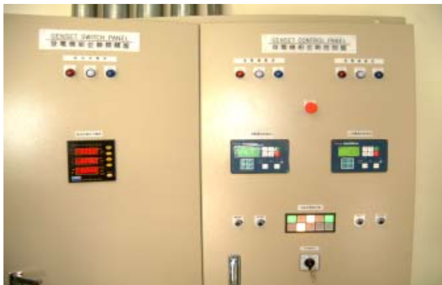
IG-CU 發電機控制器 於翡翠水庫水生館， 200kw 發電機兩機並 聯控制盤，應用實 例。
