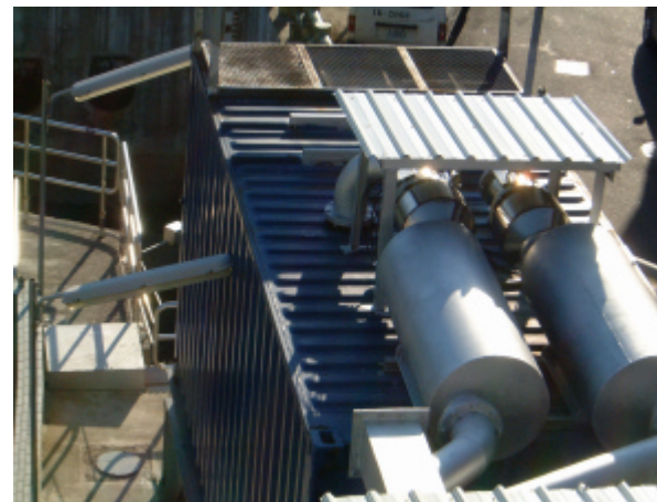
貨櫃式發電機加裝觸媒排煙淨化器解決了困擾
