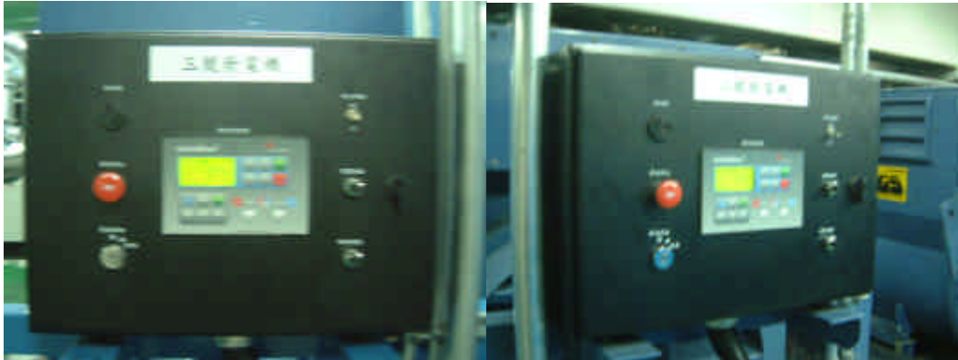
IG-NT 發電機控制器
