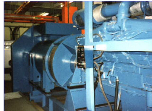
Hitzinger UPS Type NBDD 1000 kVA
