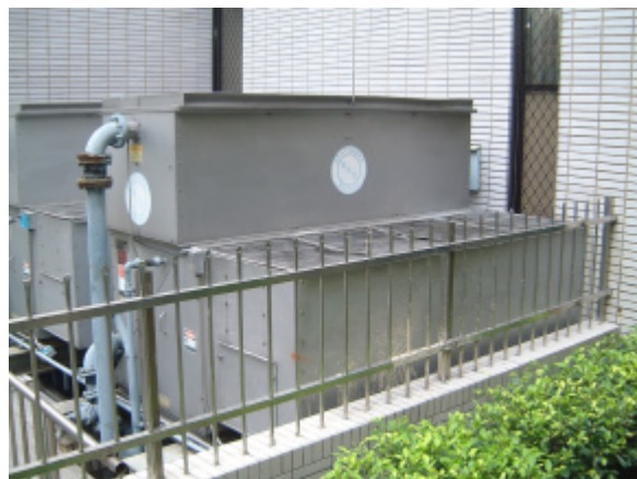
中華電信緊供發電機冷卻用 BAC 水塔
