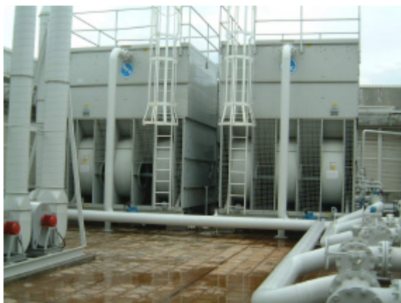
台塑麥寮 York 冰水機冷卻用 BAC 水塔
