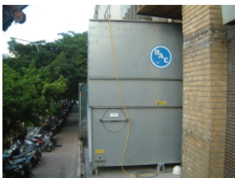
博愛特區用 BAC V 型冷卻水塔
