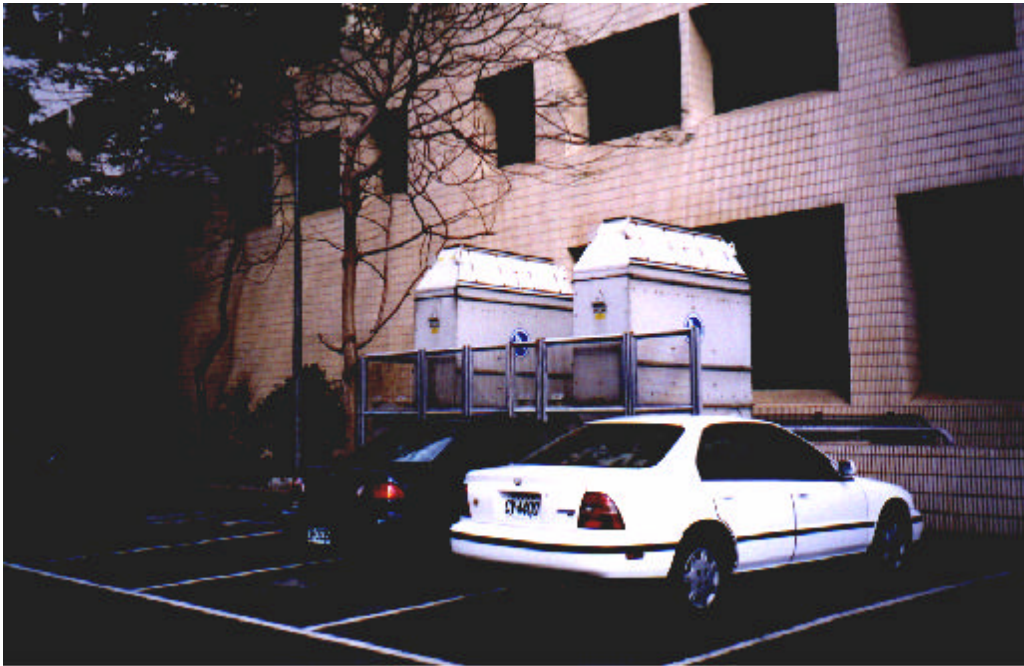
BAC MODEL: VT0-75 型兩台, 用於發電機之冷卻循環系統.
